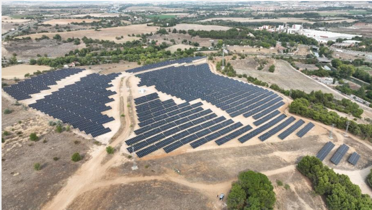
Instalación fotovoltaica de autoconsumo industrial sobre suelo para Lingotes Espaciales SA. Potencia de 5,9 MW . Castilla y León. Finalizada en Julio 2024
