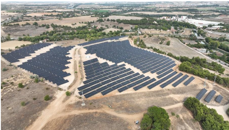
Instalación fotovoltaica de autoconsumo industrial sobre suelo para Linqotes Espaciales SA. Potencia de 5,9 MW . Castilla y León.
