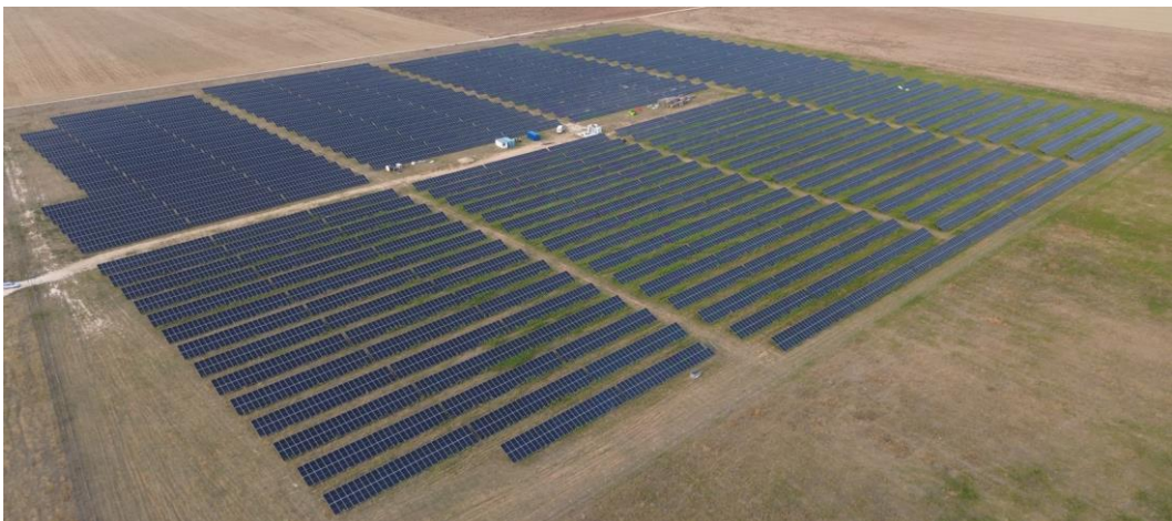
Parque generación fotovoltaica Villanubla Solar. Con una potencia de 10,39 MW . Castilla y León, Valladolid
